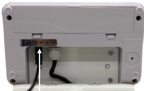
Tomada do transformador
